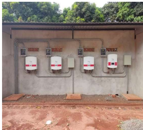
Figura 6 - Instalação Padovam Soluções em Energia
