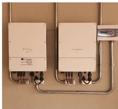
Figura 8 – Instalação Padovam Soluções em Energia
