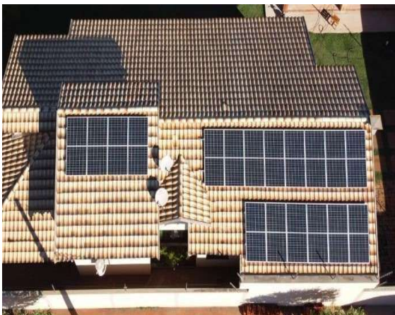
Figura 5 - Instalação Padovam Soluções em Energia
